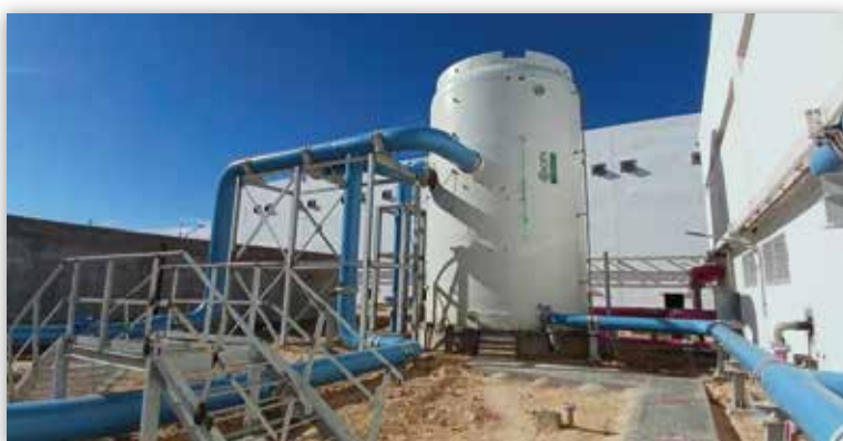
Station ZARAT de dessalement de l'eau - Sté GCER
